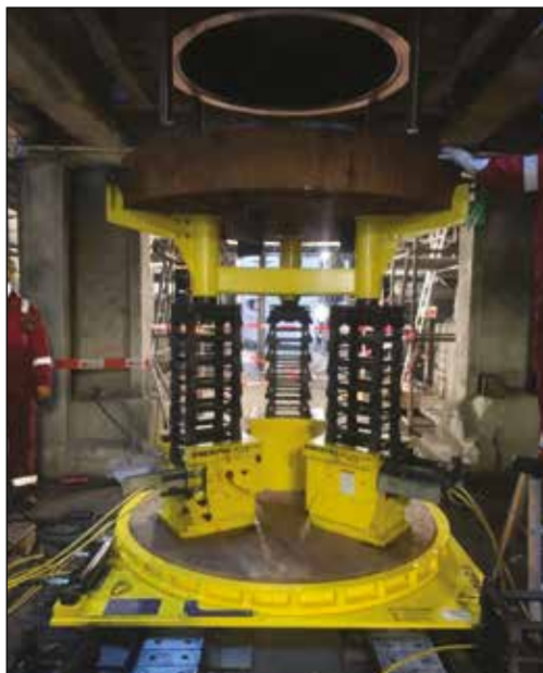
◀ Wärmeaustauscher-Wartung an Rohrleitungen und Kondensatoren einer Raffinerie mithilfe einer Kombination von Enerpac Heavy Lifting Technology: Cube Jacks der SCJ-Serie, hydraulische Drehteller der ETT-Serie und Low-Height-Gleitsysteme der LH-Serie.
